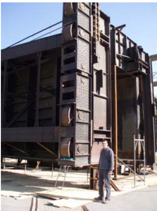
▶ Kljukasti železni zapornici z glavnimi tekalnimi vozički
