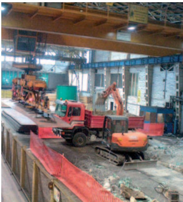
● Slika 4: Nemoteno delovanje avtomatskega zakladanja v času gradbenih del je bilo povod za avtomatizacijo granika 2A, na sliki se vidi izvajanje gradbenih del ob hkratnem nakladanju plošče na zakladalni voz. Obenem je tu še vedno prisoten upravljalec granika, ki še vedno lahko v vsakem trenutku prekine oziroma ustavi granik zaradi nepredvidenih situacij, kot je denimo padec plošče zaradi padca vakuumu.
