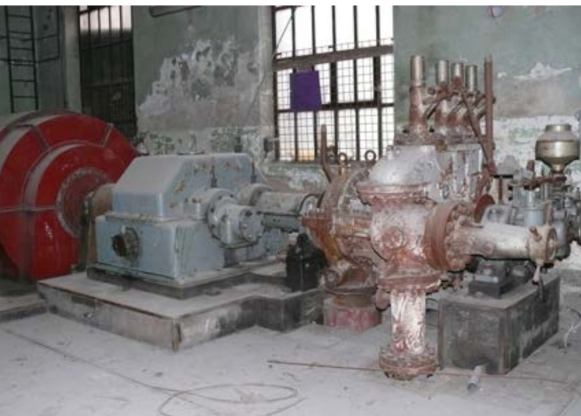
● Parna turbina v strojnici nekdanje toplotne centrale, ki je stala v bližini bivšega glavnega vhoda v jeseniško železarno
